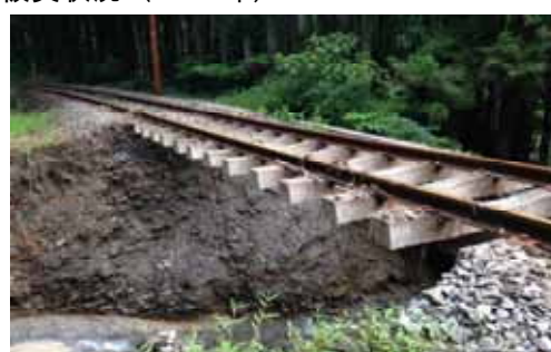
「築堤崩壊」の様子
