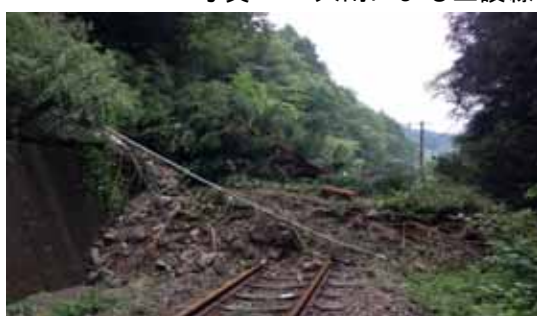
「土砂崩壊」の様子
