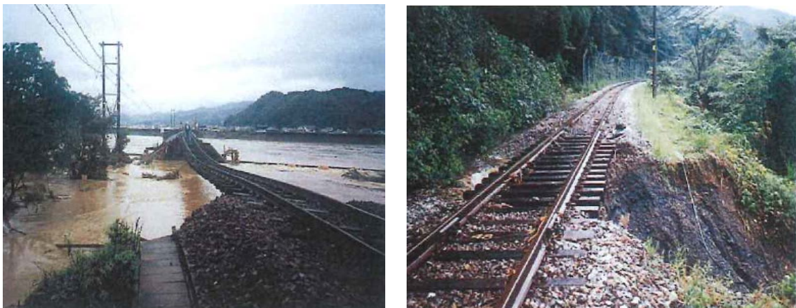
写真 2-3-10 大雨による土讃線の被災状況(1998年)
